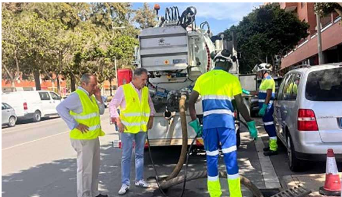
El Ayuntamiento y Aqualia subrayan que la limpieza periódica de imbornales, alcantarillas y colectores resulta fundamental para mantener la capacidad hidráulica de la red y favorecer la rápida evacuación del agua de lluvia.
